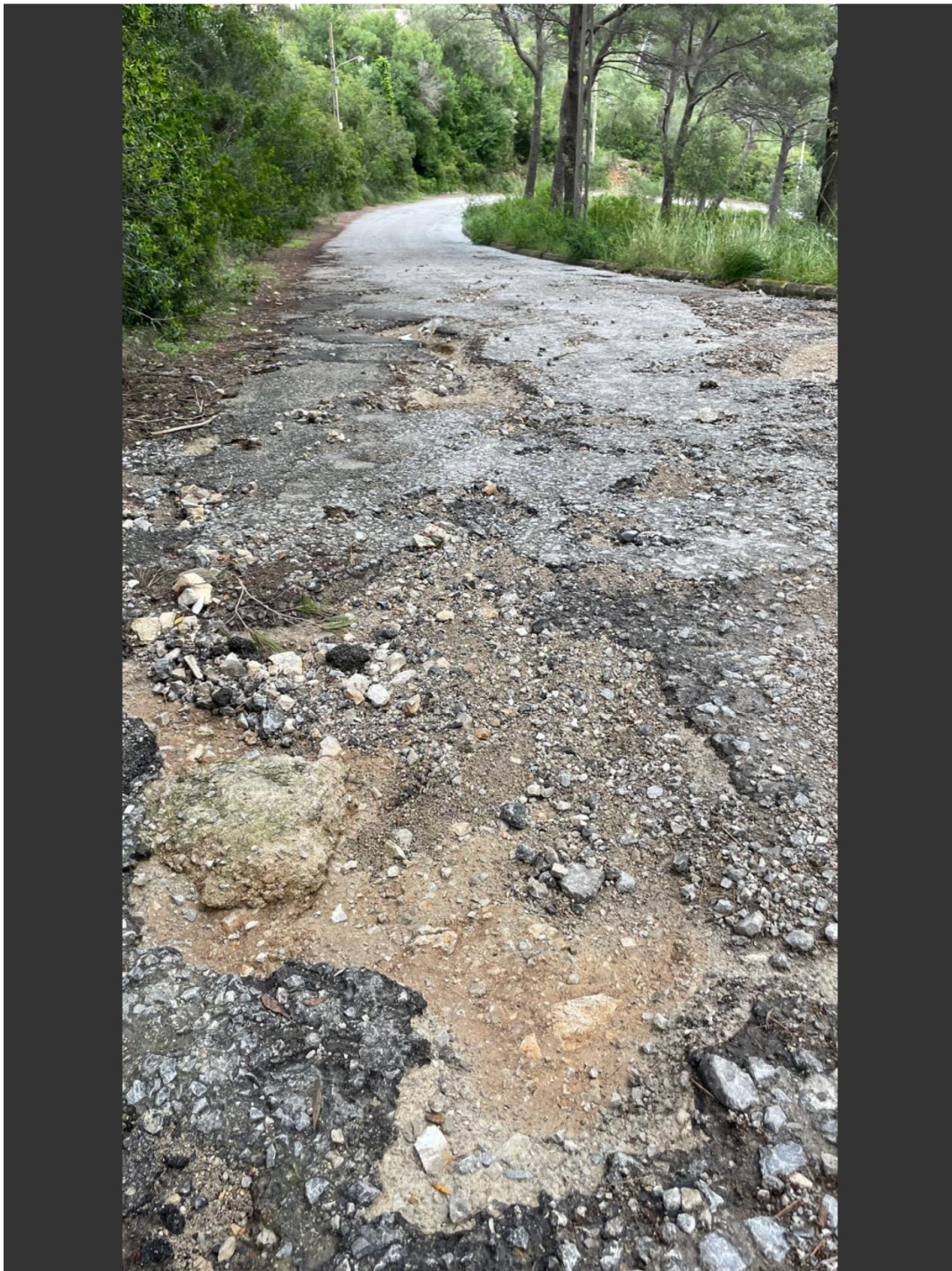
Ein Beispiel für den Zustand der Straßen in der Siedlung Costa de Canyamel bei Capdepera.
