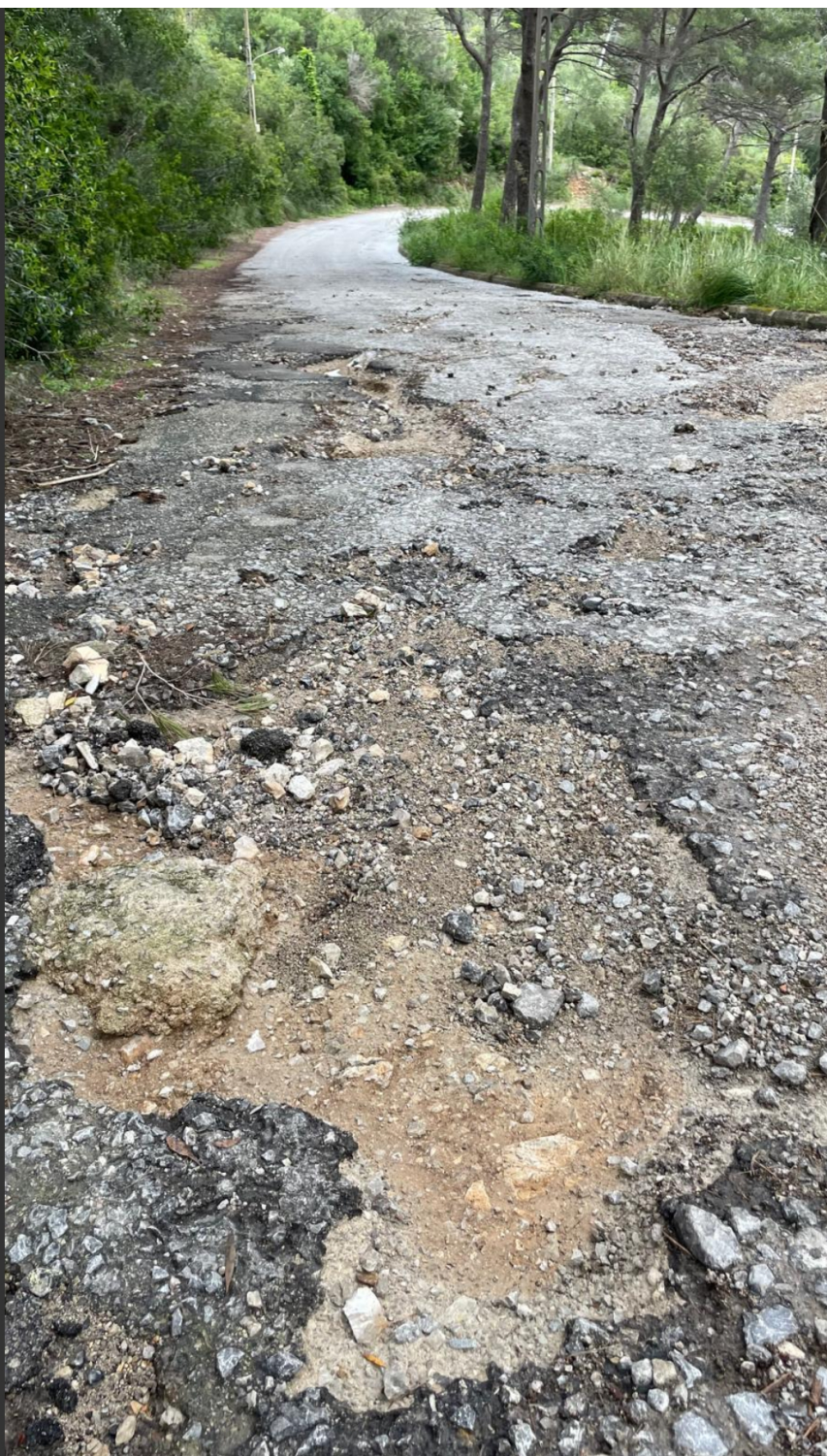
Un exemple de l'état des routes dans le lotissement de Costa de Canyamel près de Capdepera.
