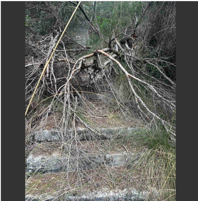
Las escaleras de evacuación de incendios están obstruidas por la maleza
